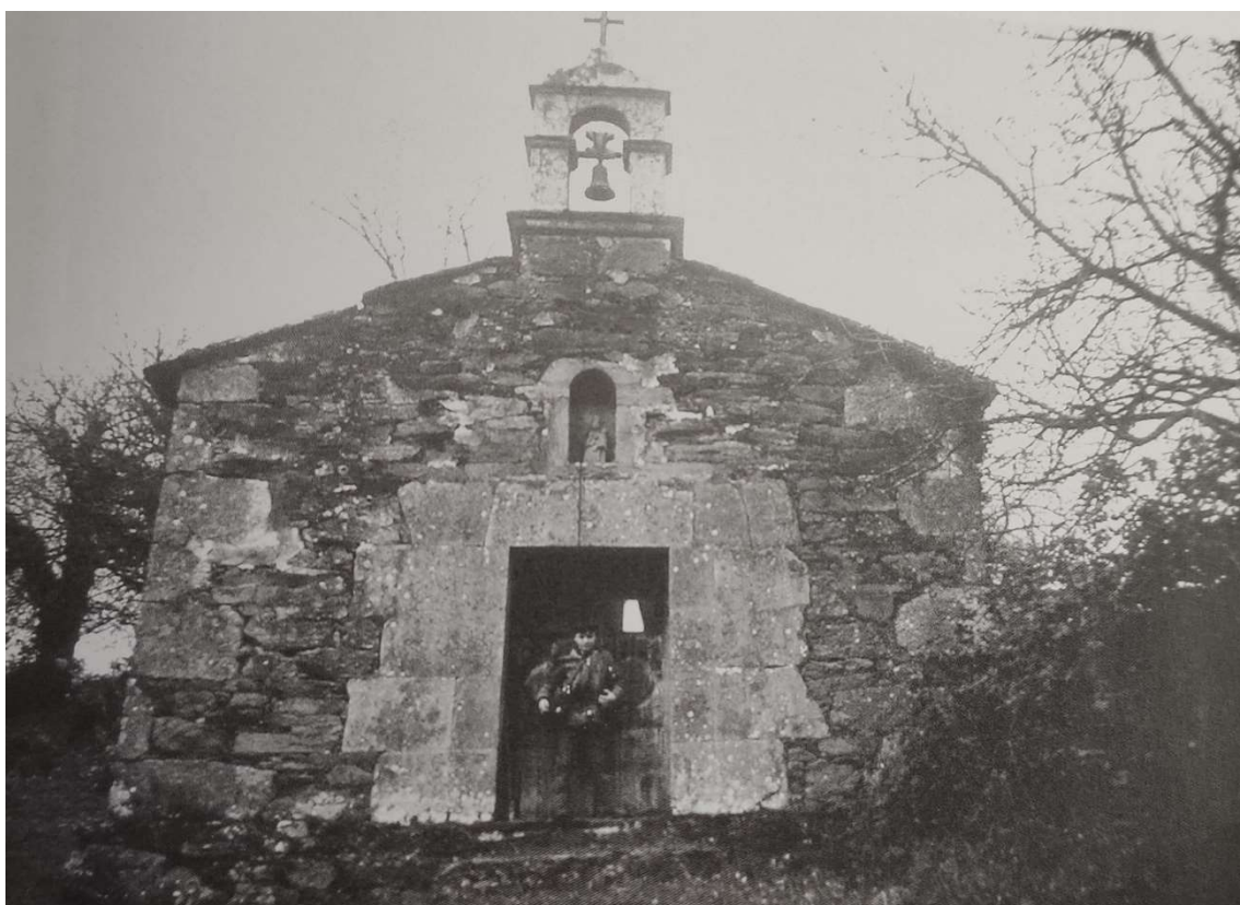
Capela da Nosa Señora de Loreto, casa do Ribeiro, (Santiso), coa campá que espaxa a tormenta nada máis empezar a tocala. Foto de finais da década dos 70, na actualidade en destacado estado de ruína (sen tellado, espadana e campá).
